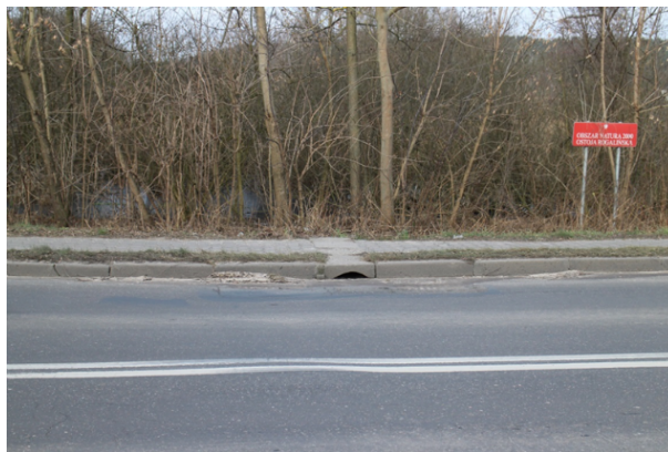
Fig. 3. Run-off from the voivodeship road no. 430 towards Lake Budzyńskie (photo D. Węclewski) Rys. 3. Spływ z jezdni drogi wojewódzkiej nr 430 w kierunku Jeziora Budzyńskiego (fot. D. Węclewski)
